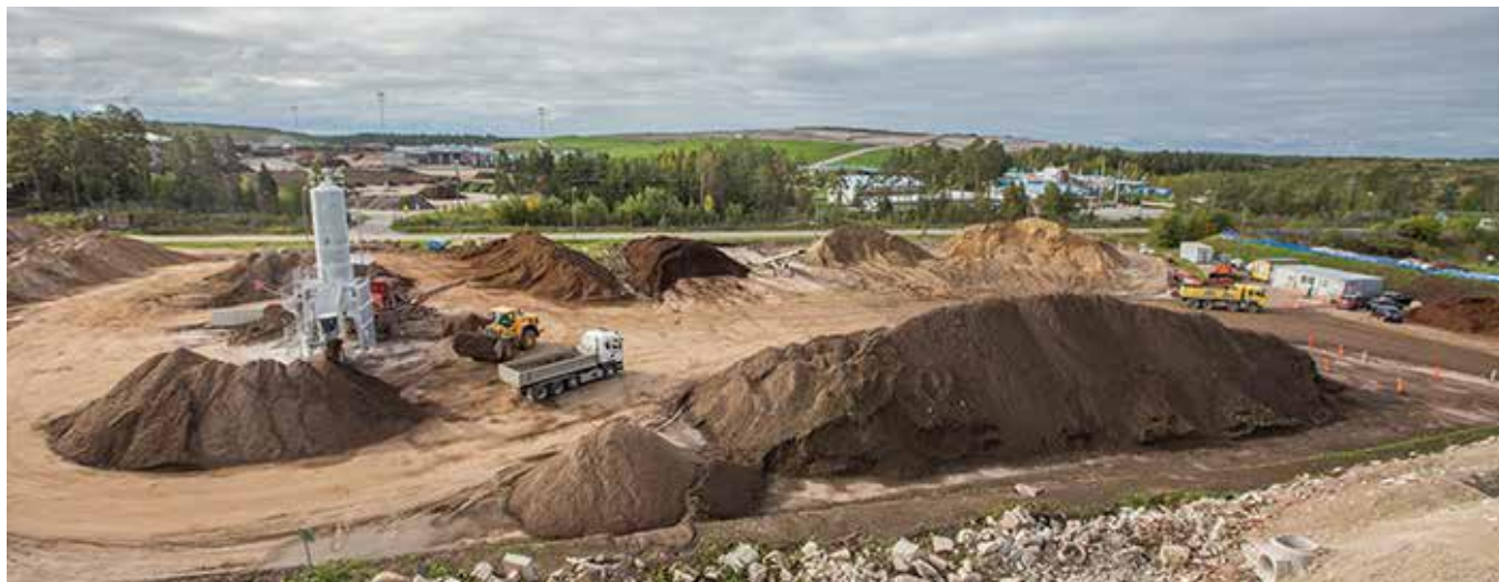
Espoon Ämmässuon multa-asema sijaitsee kaatopaikan vieressä. Kuva on syksyiltä 2013.
